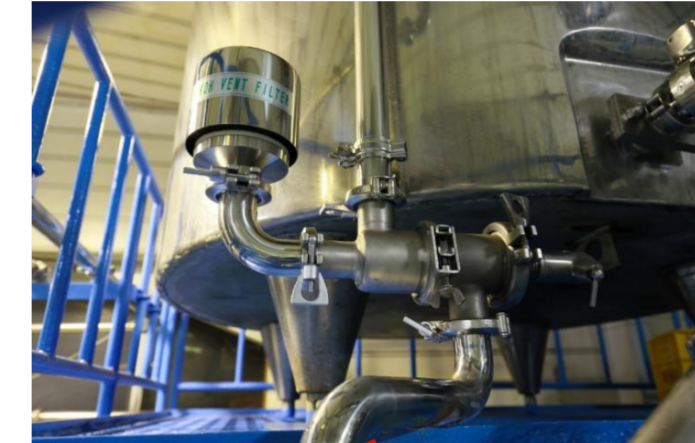
その他改善 5 サージタンク 除塵フィルターの新設
